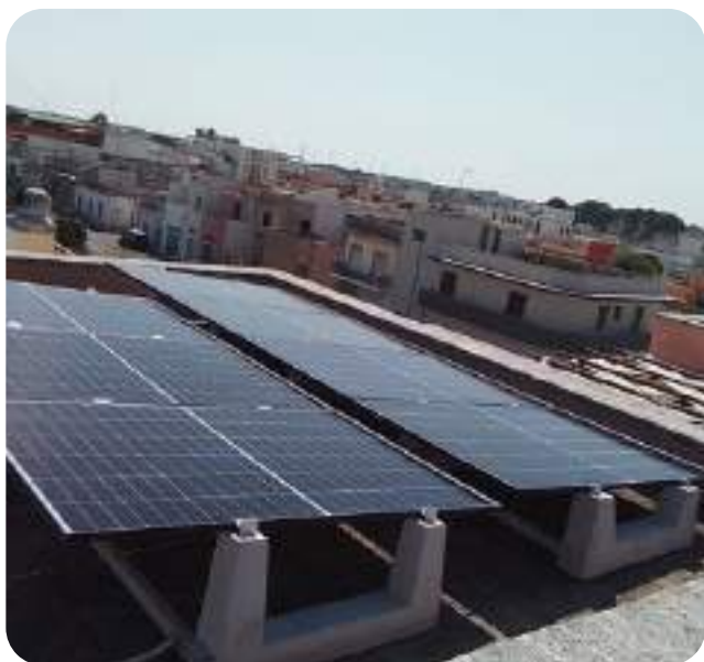
Fotovoltaico su tetto piano con strutture a zavorre, 3,08 kWp Cavallino (LE)
