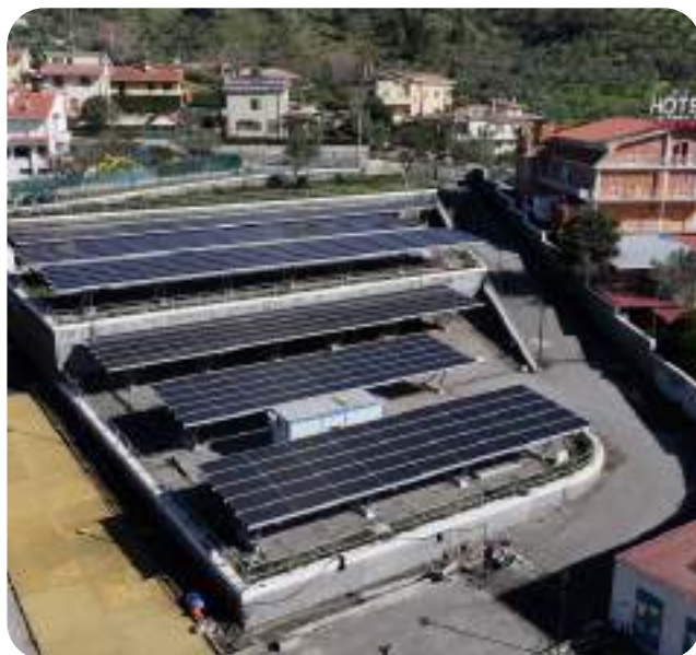
Pensilina con fotovoltaico, 256,65 kWp, Lamezia Terme (CZ)
