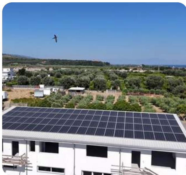
Impianto fotovoltaico, 47,95 kWp Crosia (CS)
