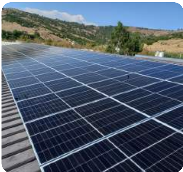
Impianto fotovoltaico, 51,15 kWp Cropalati (CS)
