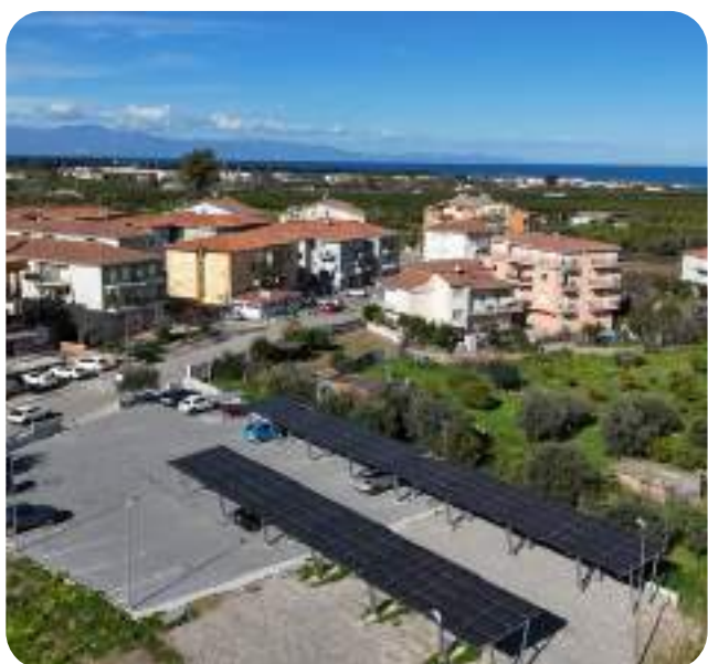
Impianto fotovoltaico, 67,76 kWp, Mirto (CS)
