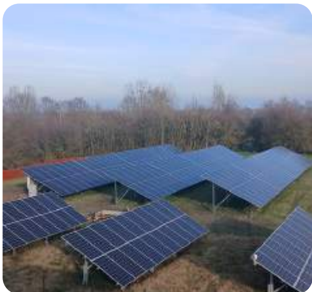
Impianto fotovoltaico, 105 kWp, Novi di Modena (MO)
