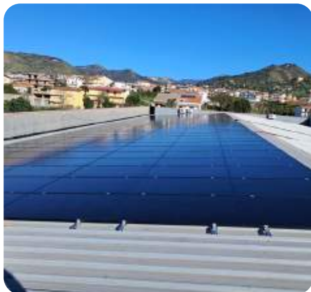
Impianto fotovoltaico, 168,00 kWp Amantea (CS)
