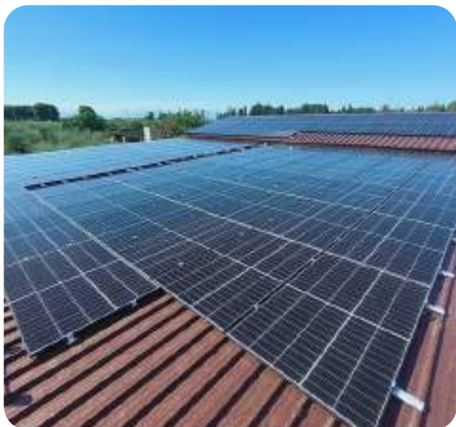
Impianto fotovoltaico, 49,38 kWp Crosia (CS)
