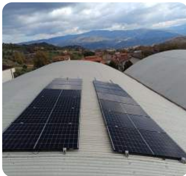
Impianto fotovoltaico, 6,02 kWp Montalto Uffugo (CS)
