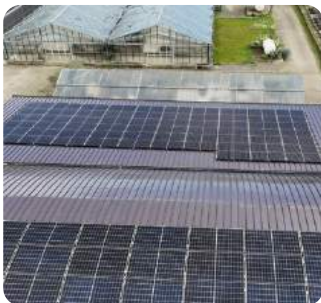
Impianto fotovoltaico, 65,12 kWp, Corigliano (CS)
