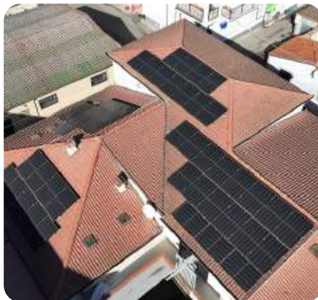
Impianto fotovoltaico, 20 kWp, Cariati (CS)
