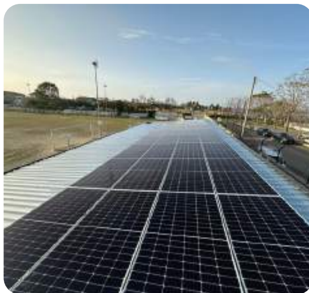
Impianto fotovoltaico, 16,48 kWp Crosia (CS)
