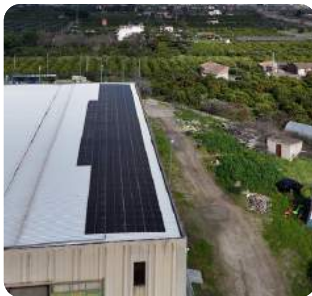
Impianto fotovoltaico, 99,68 kWp, Corigliano (CS)
