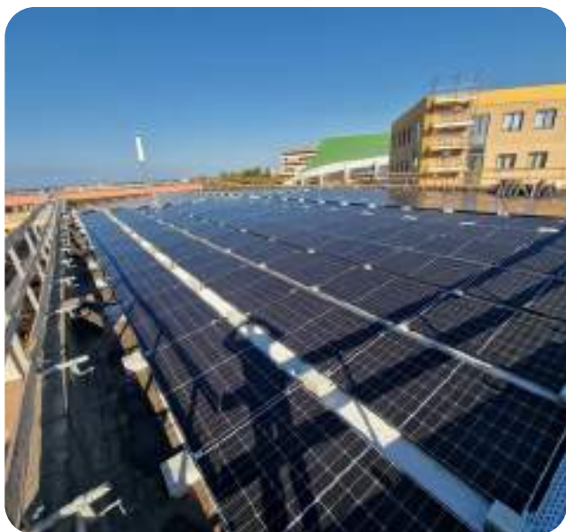
Impianto fotovoltaico, 125,84 kWp Ostia (RM)
