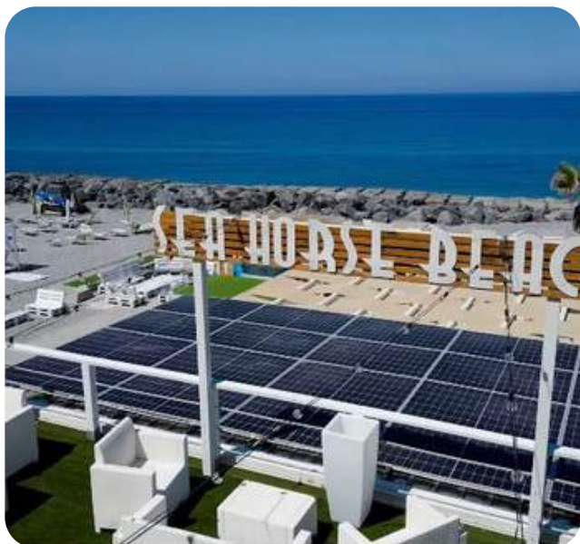
Impianto fotovoltaico, 11,48 kWp Amantea (CS)
