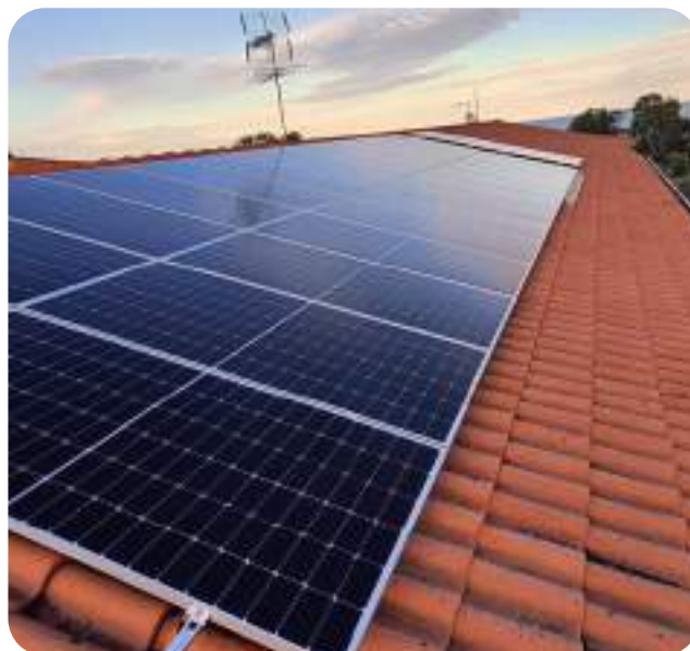
Impianto fotovoltaico, 12,09 kWp Crucoli (KR)
