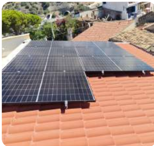
Impianto fotovoltaico, 3,185 kWp Palizzi (RC)
