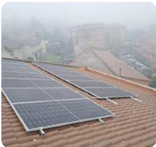
Impianto fotovoltaico, 6,045 kWp Capranica (VT)
