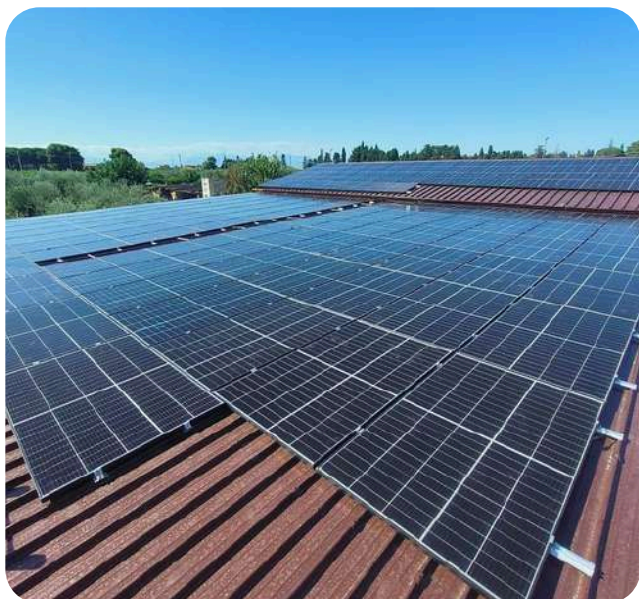
Impianto fotovoltaico, 49,38 kWp Crosia (CS)
