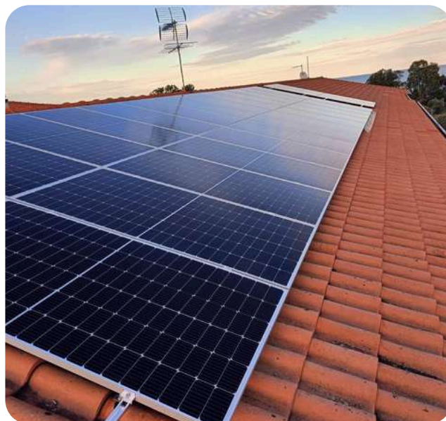
Impianto fotovoltaico, 12,09 kWp Crucoli (KR)
