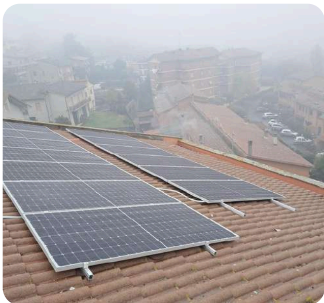
Impianto fotovoltaico, 6,045 kWp Capranica (VT)
