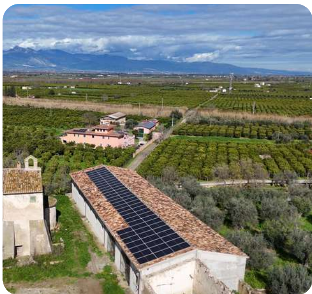
Impianto fotovoltaico, 31,52 kWp, Corigliano (CS)
