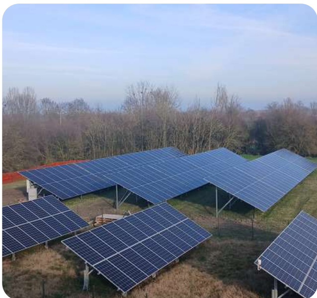
Impianto fotovoltaico, 105 kWp, Novi di Modena (MO)
