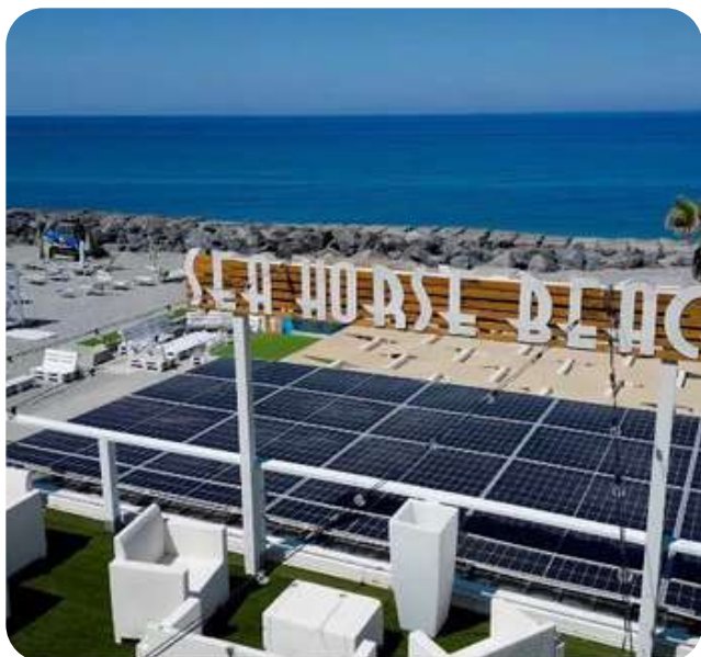
Impianto fotovoltaico, 11,48 kWp Amantea (CS)
