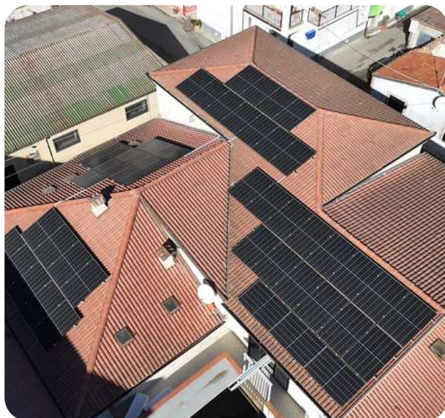
Impianto fotovoltaico, 20 kWp, Cariati (CS)
