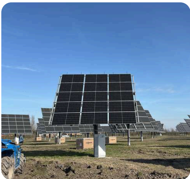
Impianto fotovoltaico, 1 MWp, Concordia (MO)
