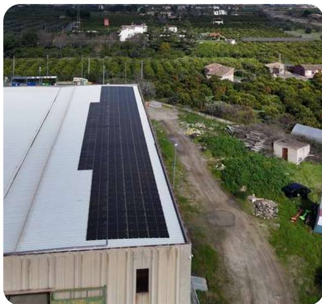
Impianto fotovoltaico, 99,68 kWp, Corigliano (CS)
