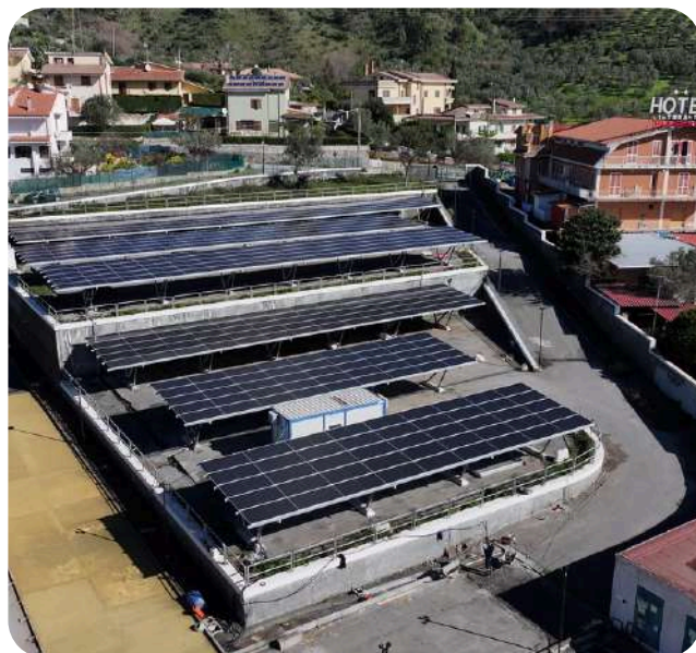
Pensilina con fotovoltaico, 256,65 kWp, Lamezia Terme (CZ)
