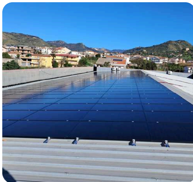
Impianto fotovoltaico, 168,00 kWp Amantea (CS)
