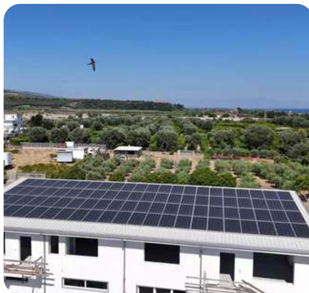
Impianto fotovoltaico, 47,95 kWp Crosia (CS)
