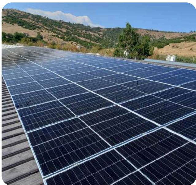
Impianto fotovoltaico, 51,15 kWp Cropalati (CS)
