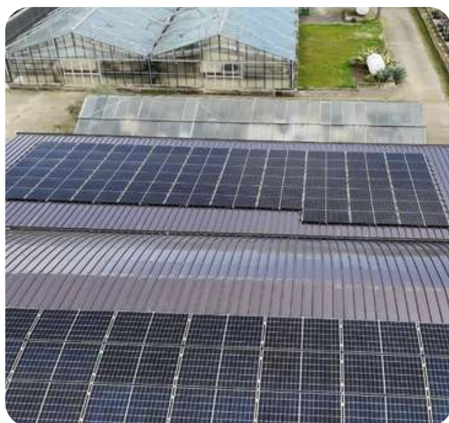
Impianto fotovoltaico, 65,12 kWp, Corigliano (CS)
