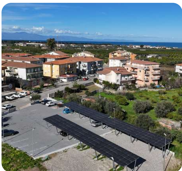
Impianto fotovoltaico, 67,76 kWp, Mirto (CS)
