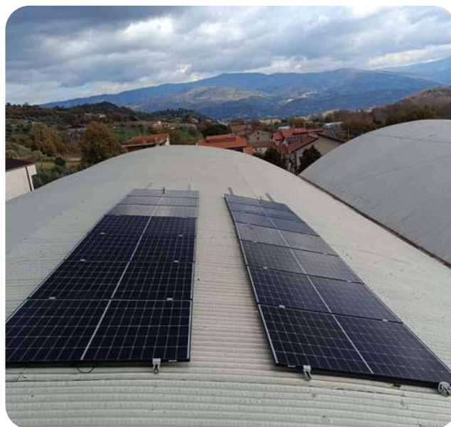
Impianto fotovoltaico, 6,02 kWp Montalto Uffugo (CS)
