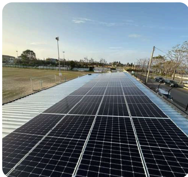
Impianto fotovoltaico, 16,48 kWp Crosia (CS)
