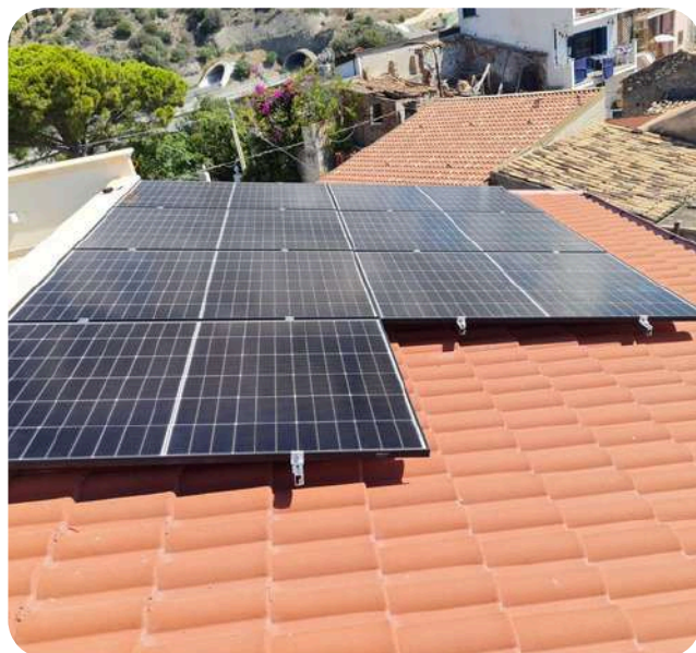
Impianto fotovoltaico, 3,185 kWp Palizzi (RC)
